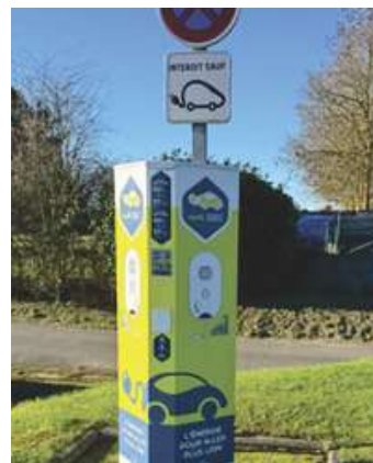
Borne de recharge de véhicule électrique MobiSDEC Charging Station, 3 route de la Fontaine St Martin (Parking de la mairie, ouvert 24h/24h)
